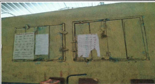
Foto 3: Se necesita la sustitución de ventanas de madera por ventana de metal con sus respectivos vidrios.
