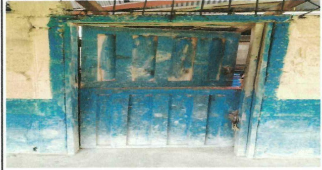
Foto 2: Se observa el mal estado del marco superior de la puerta y la reparación de la misma y la sustitución de puerta de madera a puerta de metal.
